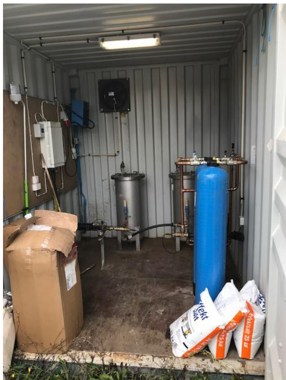
Figur 34. Reningsverket med de olika filtren.
