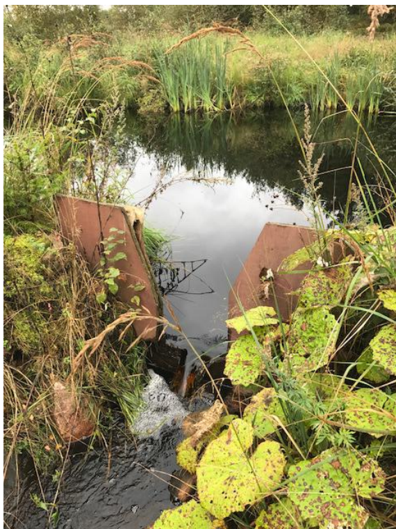
Figur 18. Utsläppspunkt vid Flybo efter sedimentationsdammarna men före våtmarken på annans mark. Provpunkt B.
